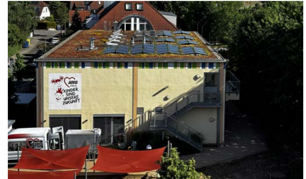
PV-Anlage zur Stromversorgung des Kindergartens
